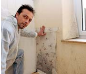
Michael Behner, der sich zur Fachkraft für Schimmelpilzsanierung ausbilden lassen hat, staunt über die vielen Schimmelspuren in einer Wohnung mitten in Lehe. Schlechte Dämmung oder Wärmebrücken waren hier weniger die Ursache, vielmehr falsches Lüftungs- und Heizverhalten der ehemaligen Mieter. Foto eer
